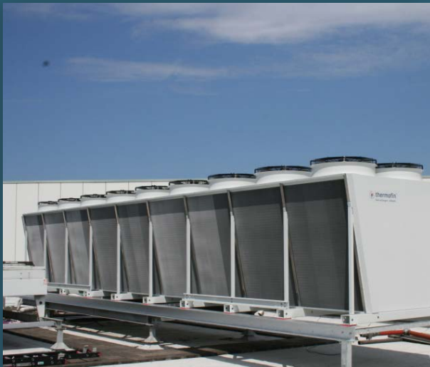
Collectieve lucht-water warmtepomp
